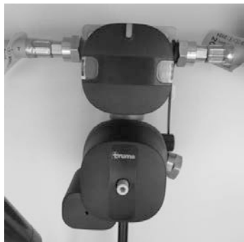
Bild 74: Gasolsystem (med Eis-Ex och fjärrindikator)
