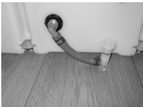
Fig. 90 : Exemple de vanne de vidange
