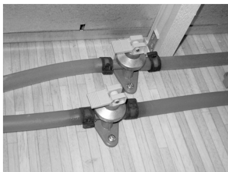
Fig. 171: Vannes de vidange fermées
