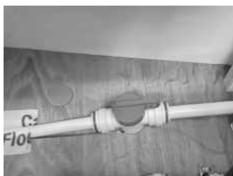
Fig. 86 : Vanne du chauffage au sol ALDE
