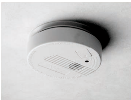
Fig. 41: Détecteur de fumée
