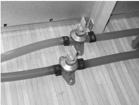
Fig. 97: Vannes de vidange ouvertes
